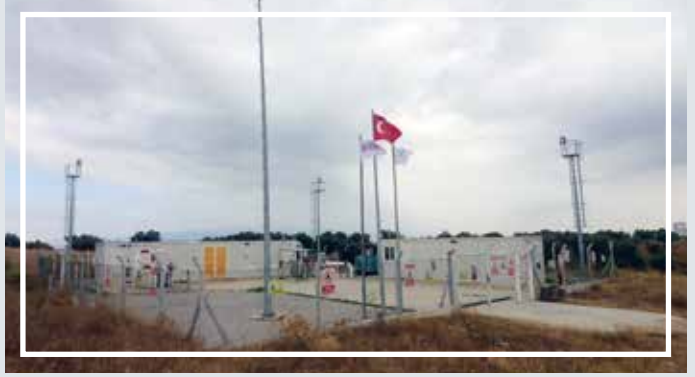
RM/A Doğalgaz İstasyonu
